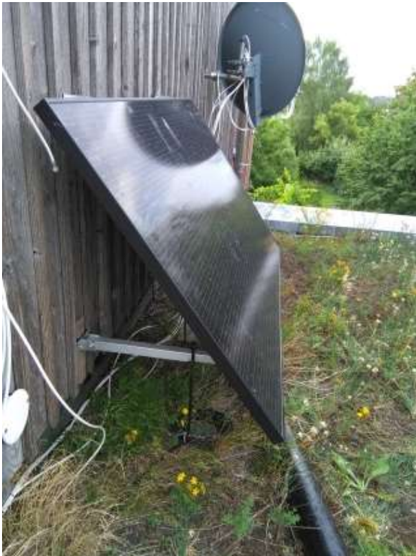
Modul - schräg an Hauswand befestigt
